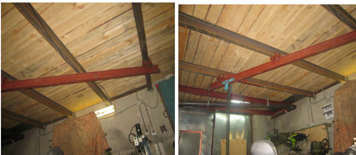
Рис. № 1.2. Потолочные неподвижные направляющие и рабочий ход кран-балки
