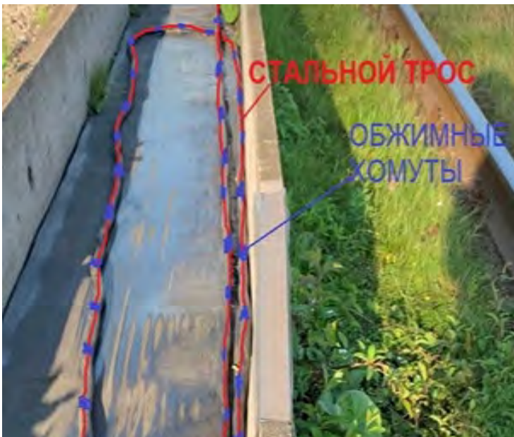
Рис. № 5.3. Кабельный лоток крана после модернизации. Кабель тянется краном за стальной трос.
