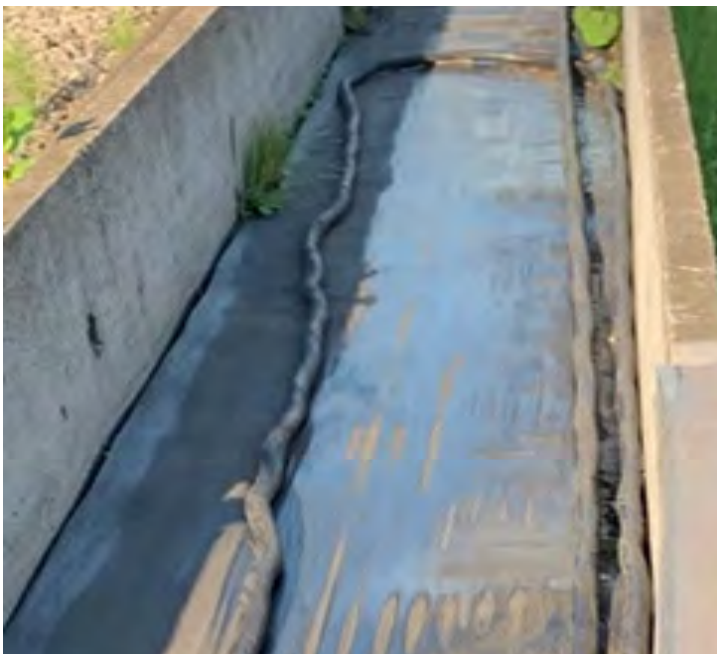
Рис. № 5.2. Кабельный лоток крана до модернизации. Кабель тянется краном за изоляцию.
